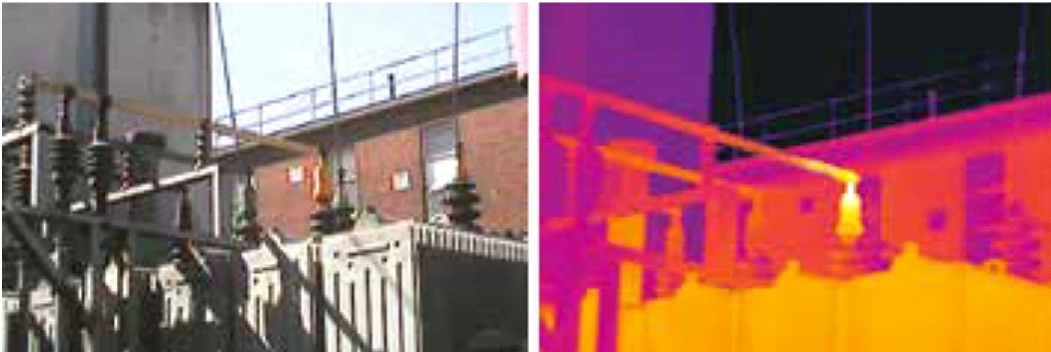
Figura N° 4. Detección de zonas sobrecalentadas por alta resistencia eléctrica en una subestación transformadora. Fuente: FLIR Systems, 2011.
